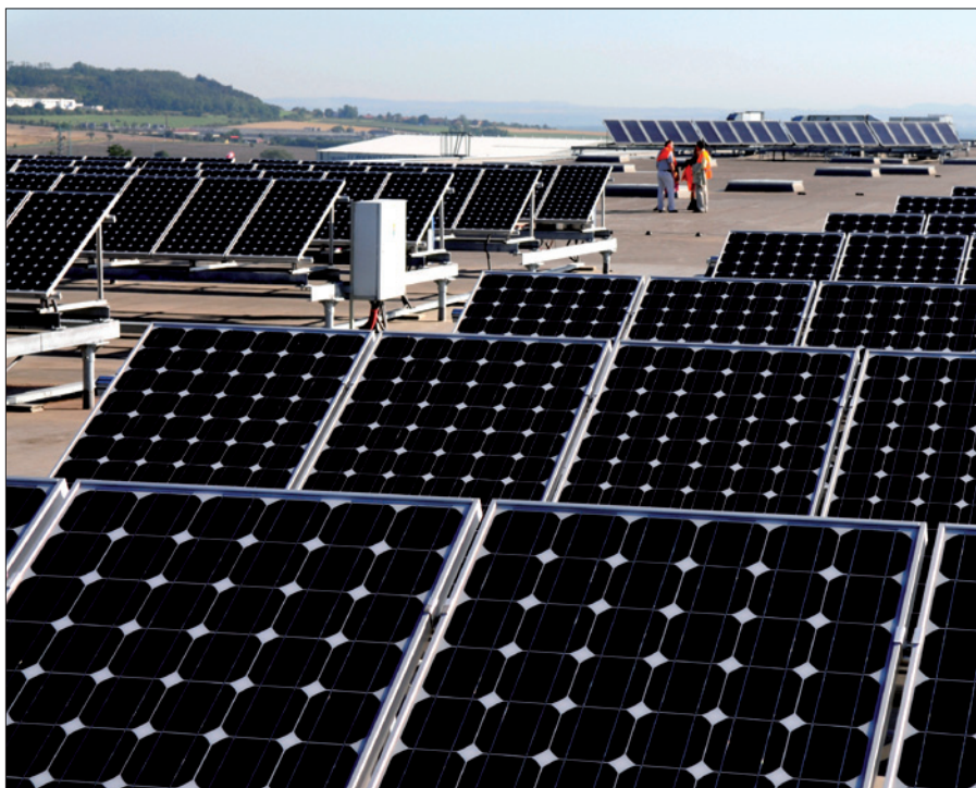
Obr. 1. Společnost Tesco Stores ČR vybudovala na střeše svého distribučního centra v Postřizíně fotovoltaickou stanici s celkovým výkonem 172 kWp
